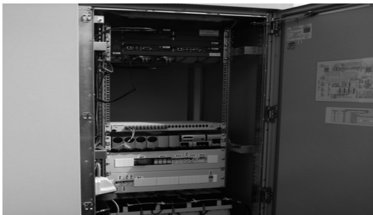
Fot. 1. Szafa dystrybucyjna i jej wyposażenie
